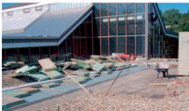
Obr. 1: Sanační opatření s materiálem Styrodur® C.
