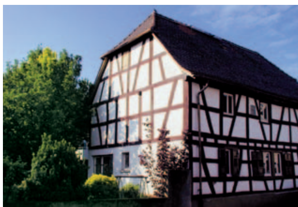
Obr. 2: V rámci projektu sanace v kooperaci s Německou agenturou pro energii dena se materiál Styrodur C používá při sanaci tohoto hrázděného domu.
