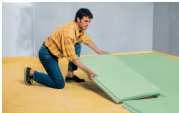
Obr. 21: Izolace podlahy s izolací proti kročejovému hluku u obytných prostor materiálem Styrodur C.
