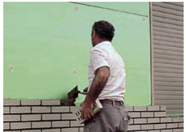
Fig. 38: Aislamiento entre hojas con ladrillos del cerramiento de la fachada de 9 cm de ancho.
