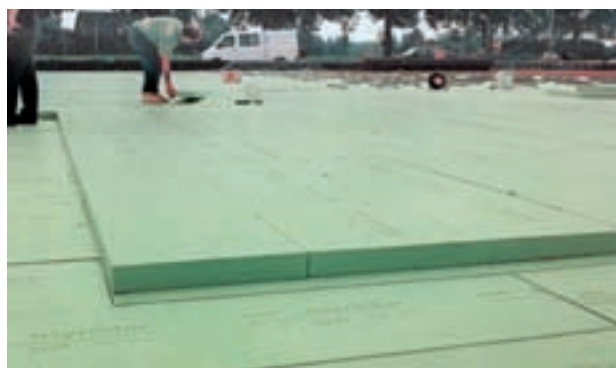
Fig. 29: Instalación de planchas Styrodur® C durante la edificación de una casa pasiva.
