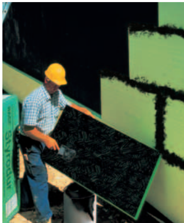
Fig. 25: Incollaggio su tutta la superficie delle lastre di Styrodur® C e degli spigoli nonché stuccatura dei giunti tra le lastre nella zona della falda acquifera.
