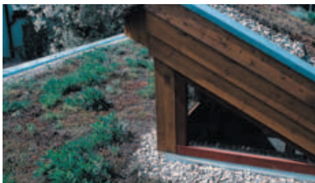
Fig. 27: Rinverdimento estensivo del tetto con piante resistenti alla siccità.
