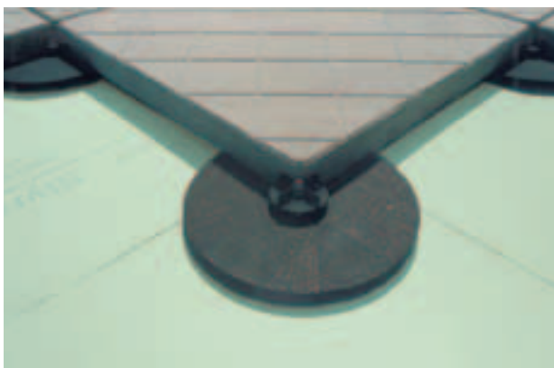
Fig. 45: Lastre di calcestruzzo posate su Styrodur® C utilizzando un sistema di supporti.
