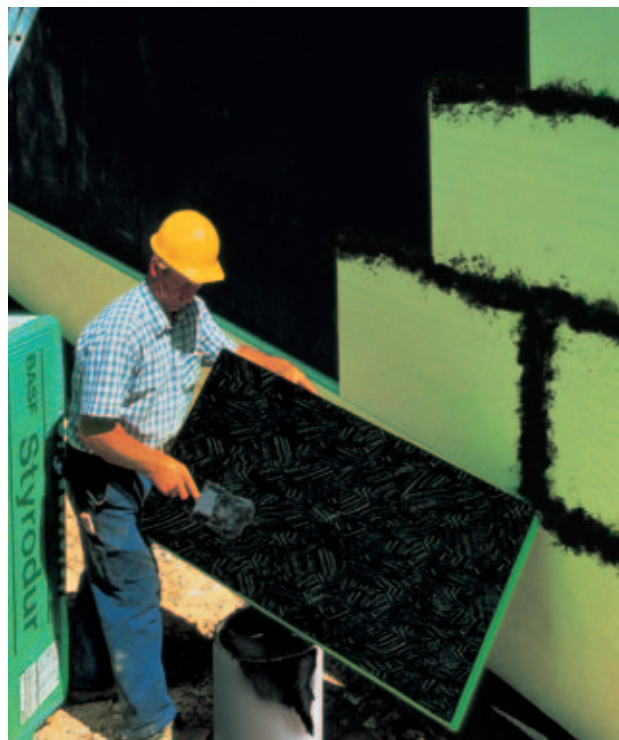
Afb. 23: Volvlakse verlijming van Styrodur® C platen en sponningen, inclusief afstrijken van de naden na het plaatsen.
