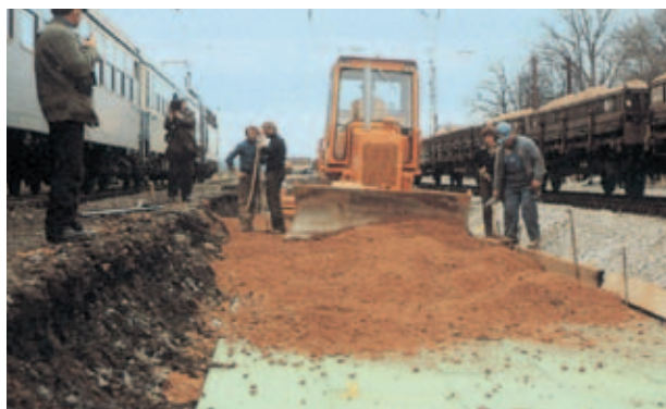
Rys. 8: Ochrona przed mrozem przy budowie podłoża toru przy zastosowaniu Styrodur C o wysokiej wytrzymałości na ściskanie.
