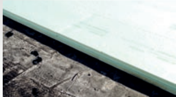
Bild 7: Die Abdichtung ist nach dem Verlegen der Dämmung optimal gegen Beschädigungen und thermische Belastungen geschützt.
