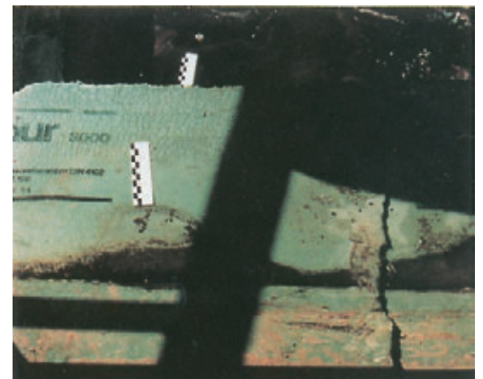
Abb. 17: Parkdach P 3. Freigelegte Styrodurdämmung. Wassergehalt nach 14jähriger Einbaudauer 4,5 Vol.-Prozent im Mittenbereich.
