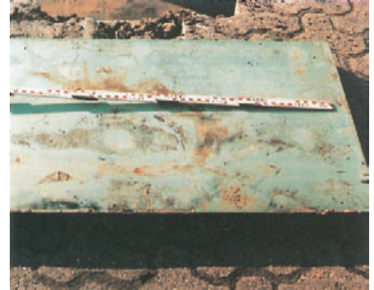
Abb. 20: Parkdach P 6. Entnommene Probeplatte, Wassergehalt 3,9 Vol.-Prozent, darüber befanden sich zwei Sandschichten, zusammen 8 cm dick.
