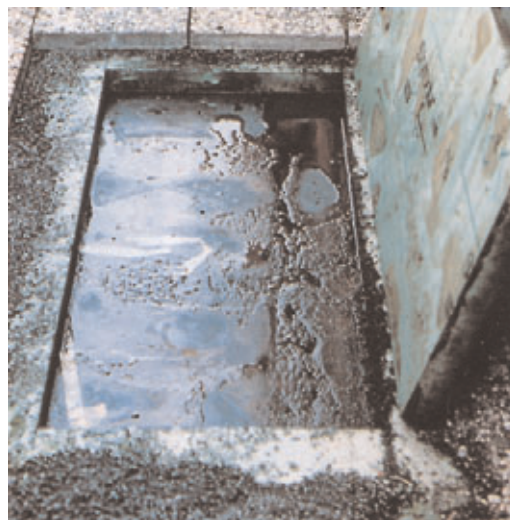
Abb. 8: Terrassendach T 2. Freigelegte bituminöse Abdichtung, auf der Wasser steht. Wegen des nassen, feinkörnigen Sandes hat die Probeplatte nach 15jähriger Einbaudauer einen Wassergehalt von 14,85 Vol.-Prozent im Mittenbereich.
