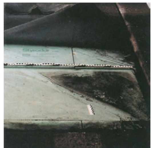
Abb. 12: Parkdach P 2. Die Stelzen haben sich nach 6jähriger Nutzung des Parkdachs nicht in die Dämmplatten (Styrodur 5000) eingedrückt. Wassergehalt 0,1 Vol.-Prozent im Mittenbereich.
