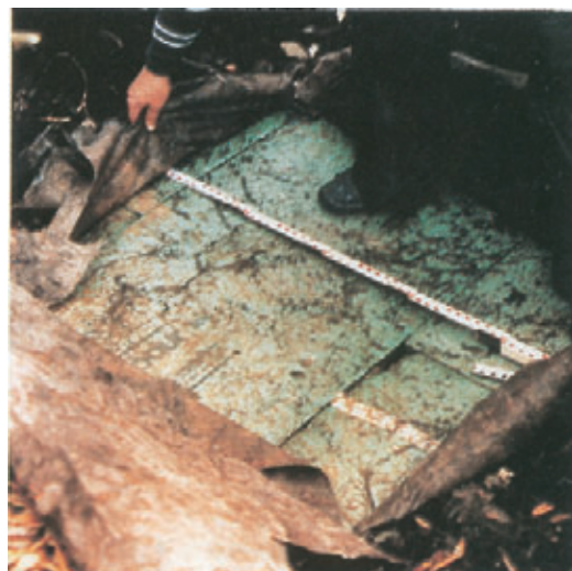
Abb. 22: Gründach G 1. Freigelegte Dämmschicht, Wassergehalt nach 11jähriger Bewitterung 1,3 Vol.-Prozent im Mittenbereich.
