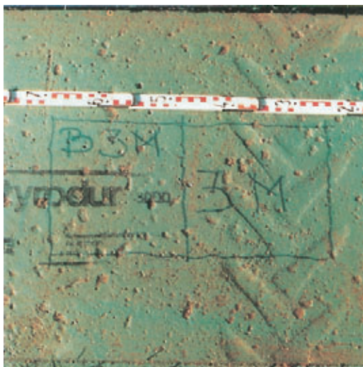
Abb. 26: Gründach G 3. Probeplatte mit Eindrücken aus der Bauzeit. Wassergehalt nach 10jähriger Bewitterung 4,3 Vol.-Prozent im Mittenbereich.
